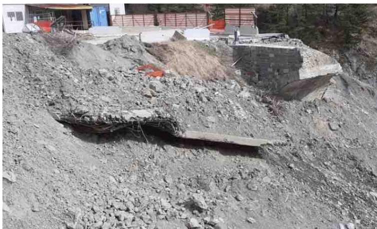
Figure 41 Rupture du plan routier du viaduc sur le Ça
