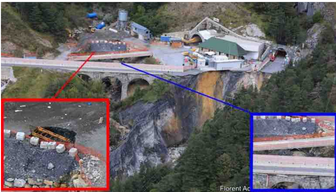
Figure 49 Zoom sur le tube et la plate-forme En bleu : Tube presque plein très recouvert, visible en aval. En rouge : Corps de la plate-forme présentant des dommages importants. Le revêtement en aval montre un phénomène d'érosion interne. Il y a un trou dans la plate-forme avec une machine de construction à l'intérieur. En arrière-plan, le réservoir bleu est bloqué à l'entrée du tuyau.
